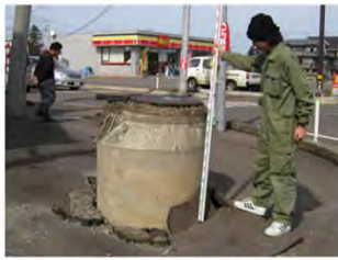
マンホールの浮上り
